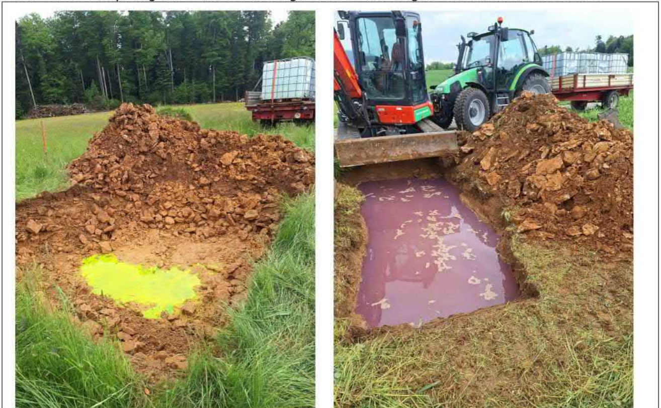
Foto 11: Wasserstand in Eingabestelle 1 beim Nachspülen
